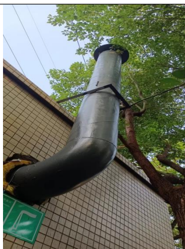
燃气锅炉排放口（DA001）
