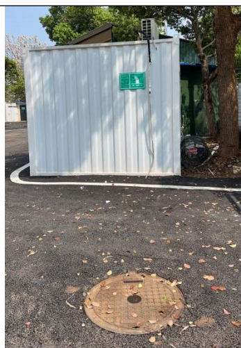
院区废水总排口（DW001）
