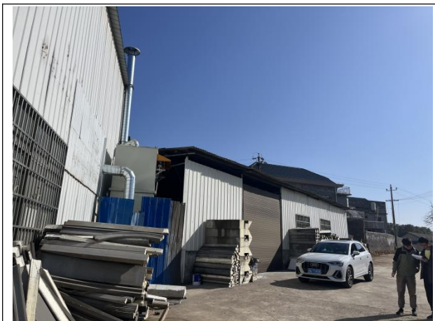
废气处理设施
