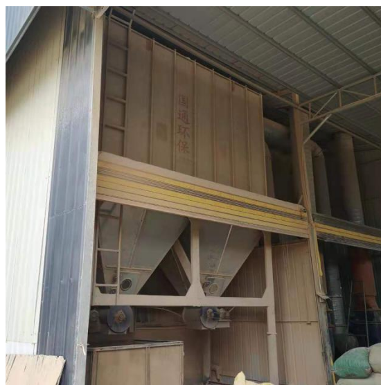
车间除尘设备
